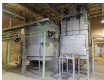
<Li-ion電池リサイクル設備>
